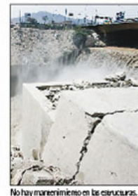
No hay mantenimiento en las estructuras.
