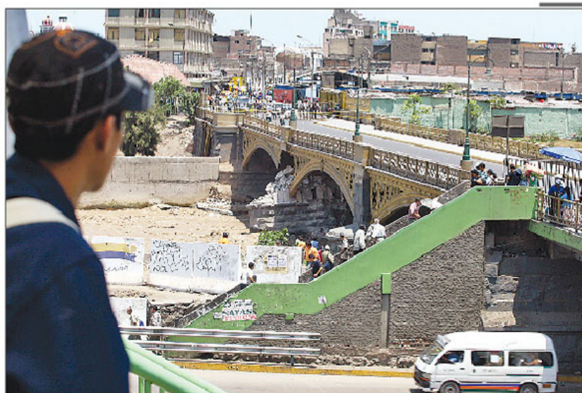
HERIDO. El histórico puente Balta sufrió un daño mayúsculo en una de sus bases por la fuerza de las aguas. Emape anunció el inicio de los trabajos de recuperación.
