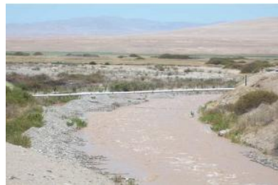
Vista fotográfica del Rio Colmatado que requiere descolmatacion.
