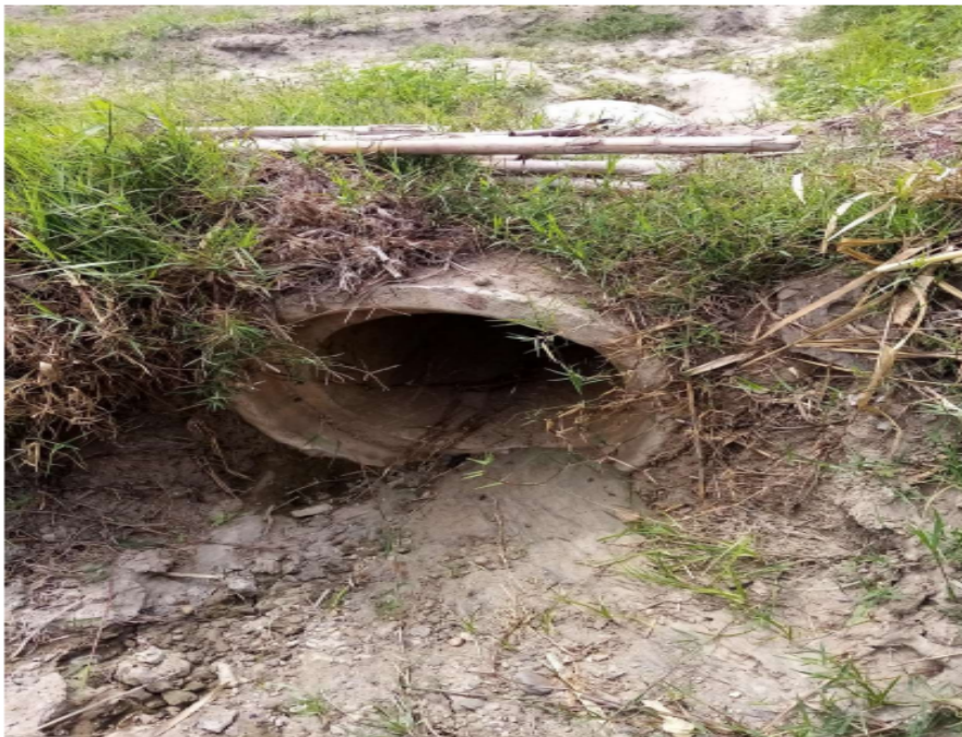
IMAGEN 03: Tubo de concreto de aproximadamente 18 pulgadas de diámetro, en las coordenadas referenciales del sistema UTM WGS84, zona datum 17 M: 0623102 E – 9238591 N. Distrito Monsefú, provincia Chiclayo, departamento Lambayeque. Fecha: 18.12.2023
