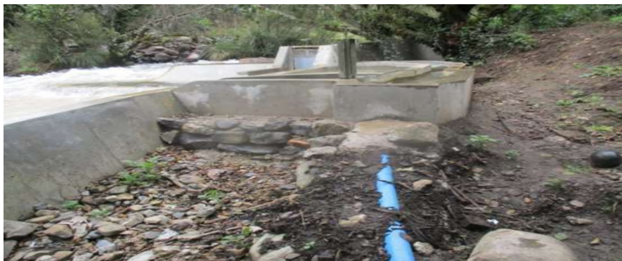
Foto: bocatoma y línea de conducción con tubería HDP
