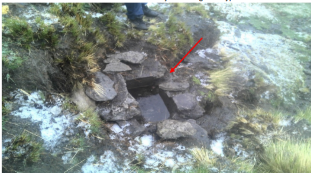
Fotografía N° 01: captacion en el manantial Condor Huachana Puquio, dañada producto de la accion del Sr. Alejandro Angulo Taype.
