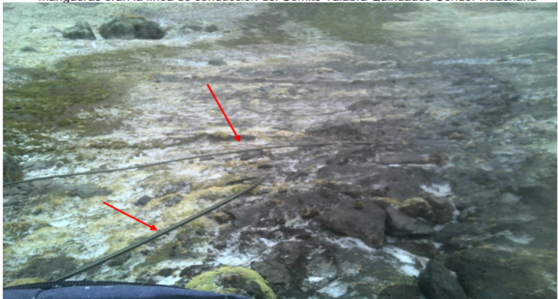
Fotografía N° 03: Las flechas indican a las mangueras dañadas y tiradas en el suelo, estas mangueras eran la línea de conducción del Comité Talabra Quinuauco Condor Huachana
