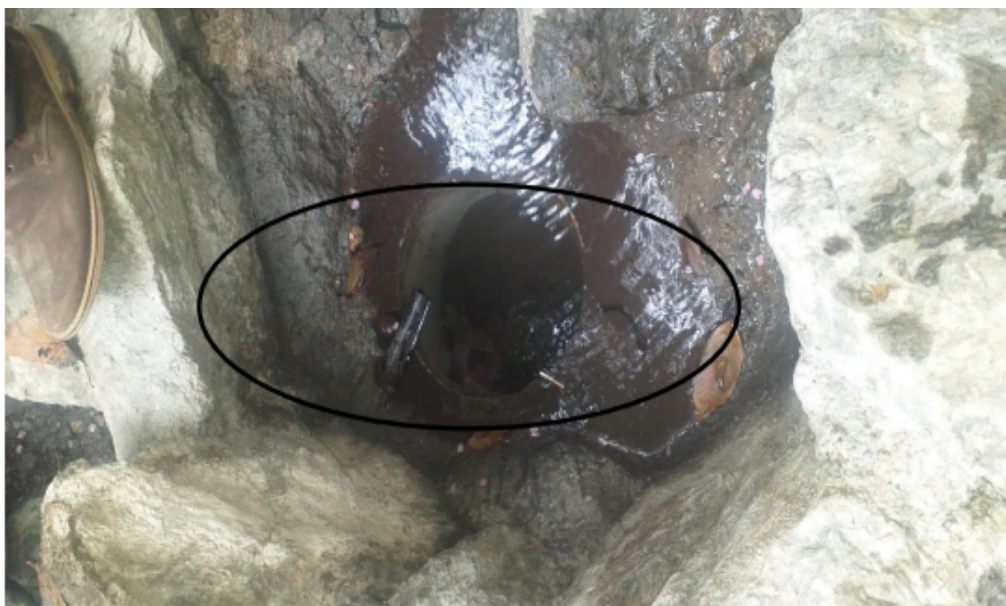
se observa que la manguera de 1 pulgada que fue instalada en el manantial Yanacollpa
