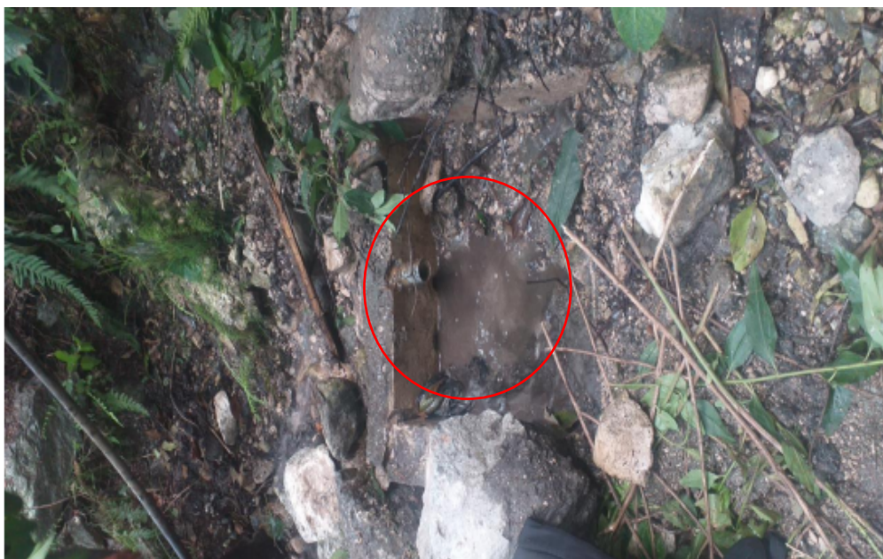
Se observa como el agua no llega a la captación del C.U.A. Yanacollpa-Pincapata
