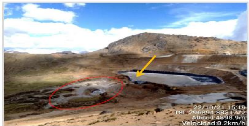
Foto N° 4 Presa de relaves mineros de nivel más bajo, donde se evidencia la rotura del dique y los relaves mineros cuesta abajo.
