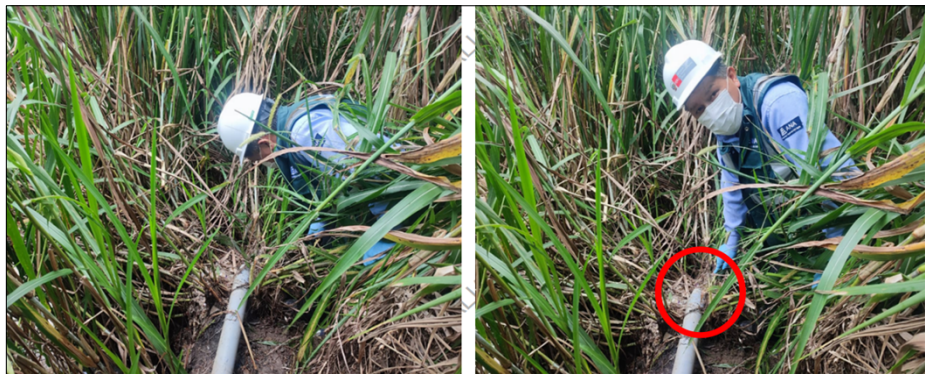
Fotografía N° 03. Descarga de aguas residuales de la vivienda por una tubería HDP de 2".
