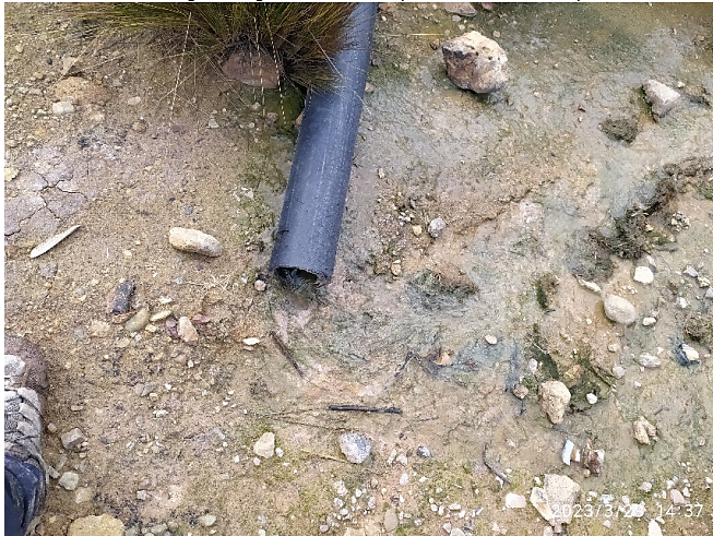
Foto N° 08: Descarga de aguas residuales provenientes de la poza colectora
