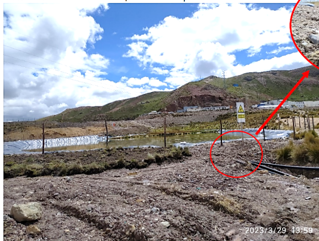
Foto N° 05: Tuberías HDPE que salen de la poza colectora
