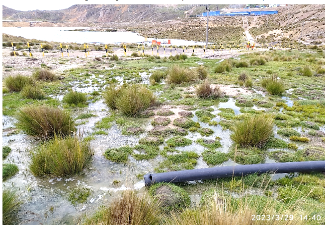
Foto N° 06: Descarga de aguas residuales provenientes de la poza colectora
