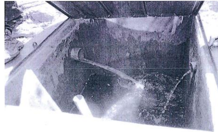
Vista fotográfica de la caja de reunión de concreto de 0.6 x 0.6 x 0.8 m, donde se visualiza el caudal de ingreso del manantial Yuraccrumi 1 (0.15 l/s); manantial Yuraccrumi 2 (0.04 l/s)
