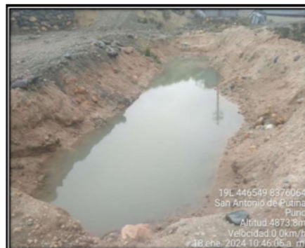
Foto N° 02: Se aprecia la poza a tajo abierto constatado, en dicha poza no se aprecia estructuras hidráulicas instaladas.
