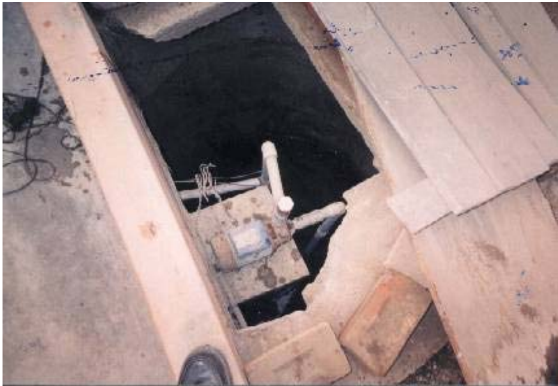
FOTOGRAFÍA N° 18 Pozo a tajo abierto utilizado y equipado con electrobomba compacta
