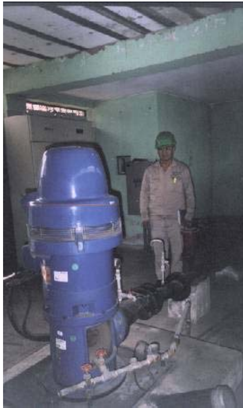
FOTOGRAFÍA N° 15 Pozo tubular equipado.
