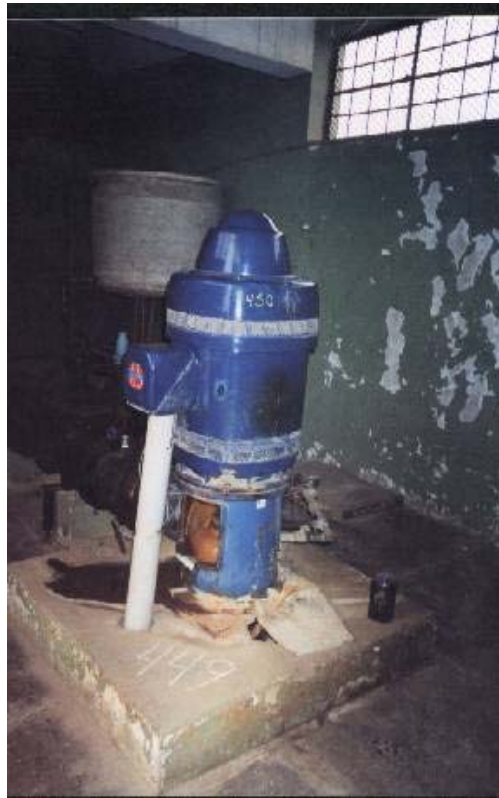
FOTOGRAFÍA N° 17 Pozo tubular equipado con motor eléctrico.
