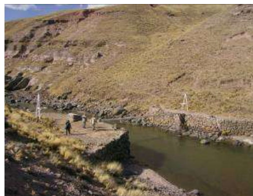
Estación de Aforo – Río Verde
