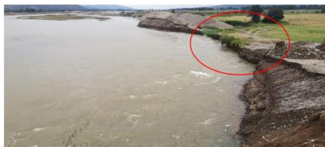
Fotografía 03: Se aprecia daños al cauce y a la margen izquierda poniendo en riesgo a terrenos de la margen Izquierda, zona de Huahuas.
