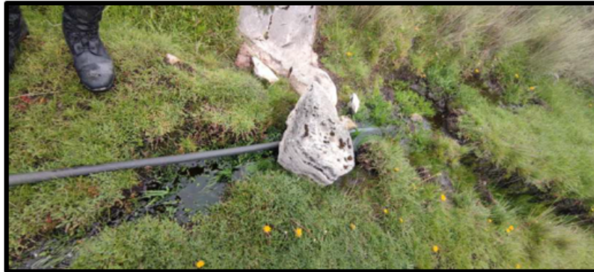
Fotografía N° 01: Se observa la tubería de 1" que conduce el agua de la Quebrada Polperia, desde la captación
