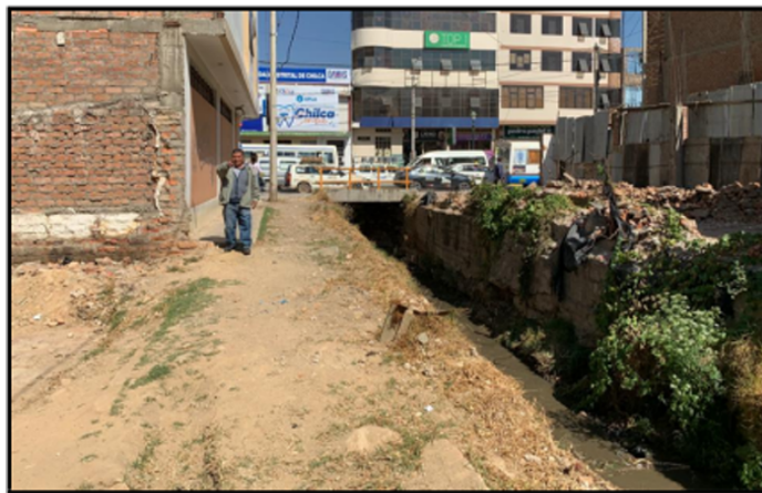
Fotografía 01: se aprecia el predio invadiendo faja marginal
