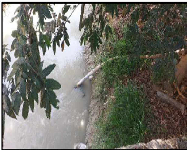
Foto 2: Tubería de succión “3”
