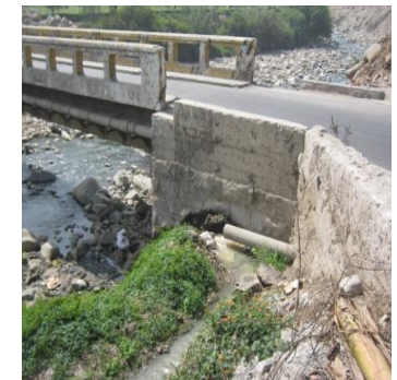
Vertimiento de aguas residuales domesticas sin tratamiento de Chosica
