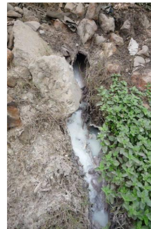
Vertimiento de aguas residuales industriales de la empresa Mantaro
