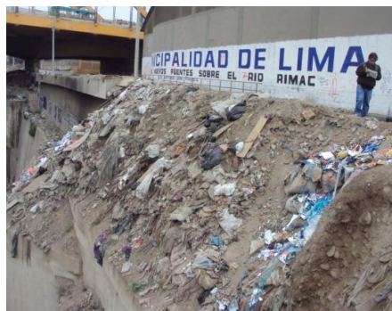
Botadero de residuos sólidos ubicado en el puente Del Ejército.
