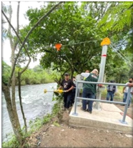
Figura N° 3 Poste, Cableado y equipo de aforo
