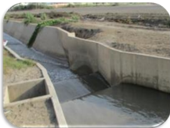
Figura N° 5 Medidor Tipo Parshall
