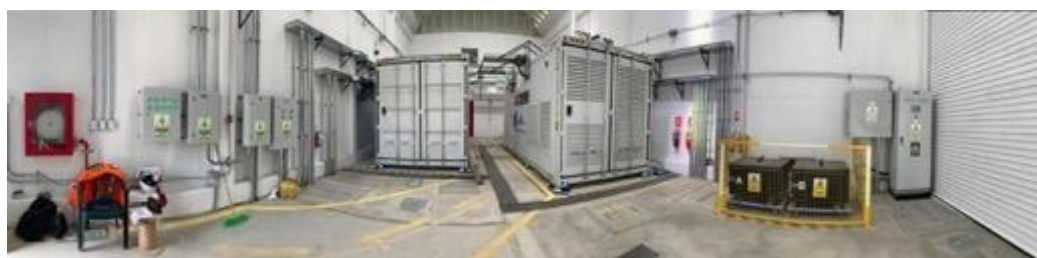
FIGURA N° 9 VISTA INTERIOR DEL CENTRO DE DATOS CON LOS SALONES COFRE INSTALADOS
