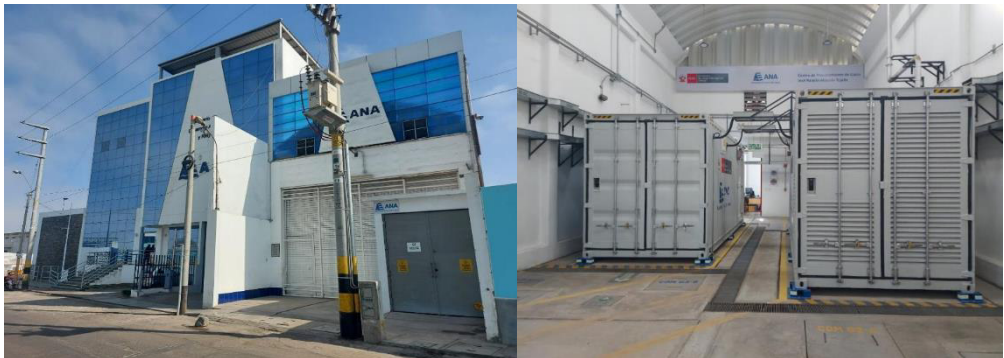
Imagen N° 07: Centro de Procesamiento de Datos Secundario en Ica
